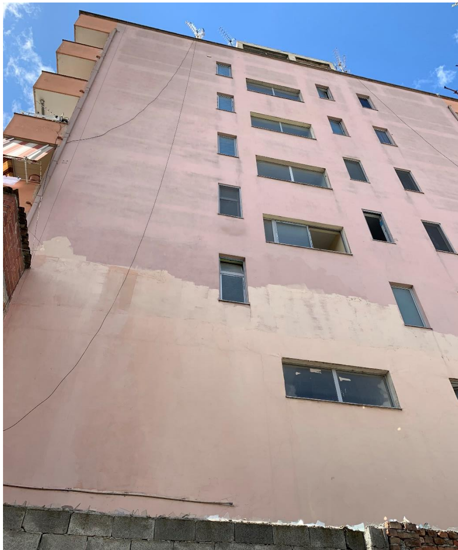
Fig.1-4 Pamje te gjendjes ekzistuese ne objekt
